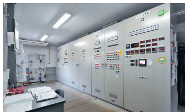
ボイラー制御室
