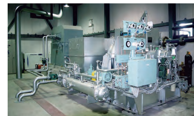
蒸気タービン
