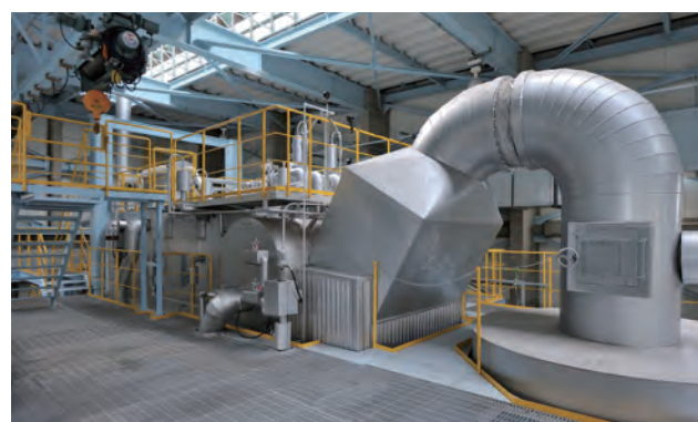
よしみね水管式廃熱ボイラ WA-460型
