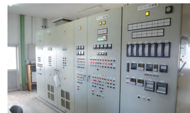
ボイラー制御室
