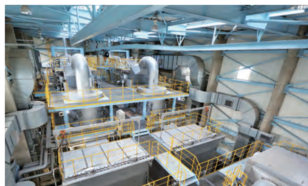
よしみね水管式廃熱ボイラ (2基)
