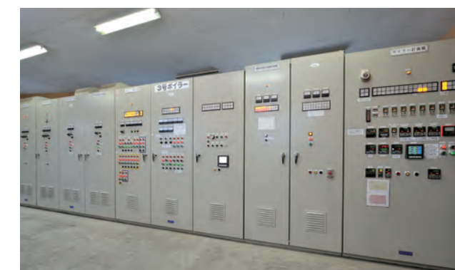
ボイラー制御室
