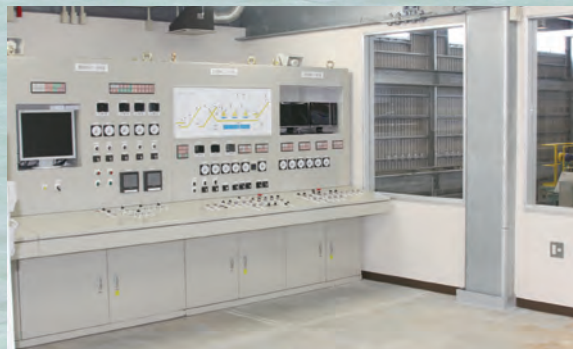
伊江村黒糖工場中央監視室
