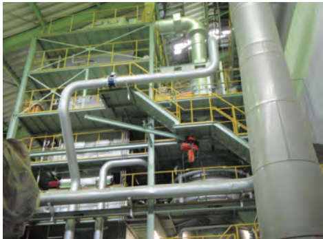
YH-400型流動床ボイラ 加茂町
